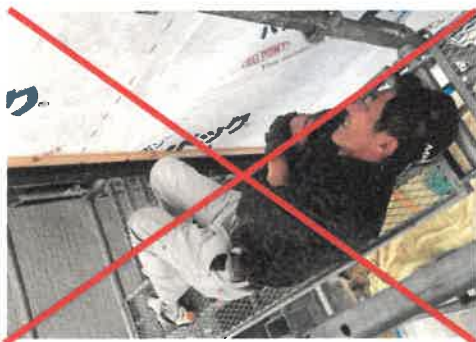
※足場で寝ない
